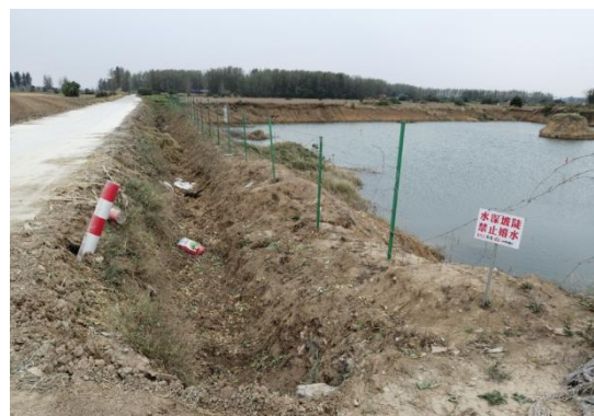
9#取土场外围排水沟
