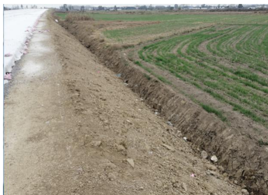
K29 路基坡脚临时排水沟
